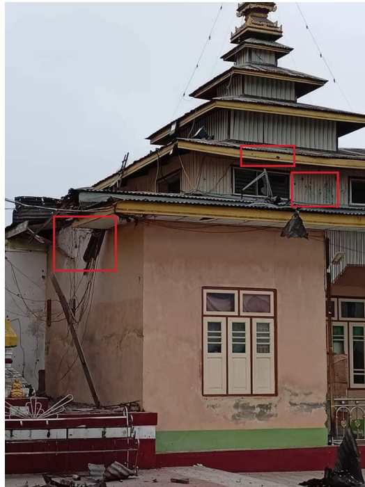
Figure 28: Signs of damage on the exterior wall of a building in Mwedaw Pagoda (မေတ္တော်ဘုန်းကြီးကျောင်း) (Source redacted for privacy concerns).
